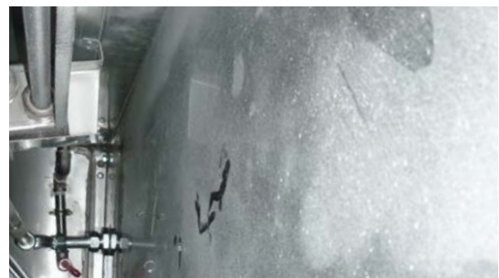
数周使用之后，安装有 UV-C 灯的风管内部图
